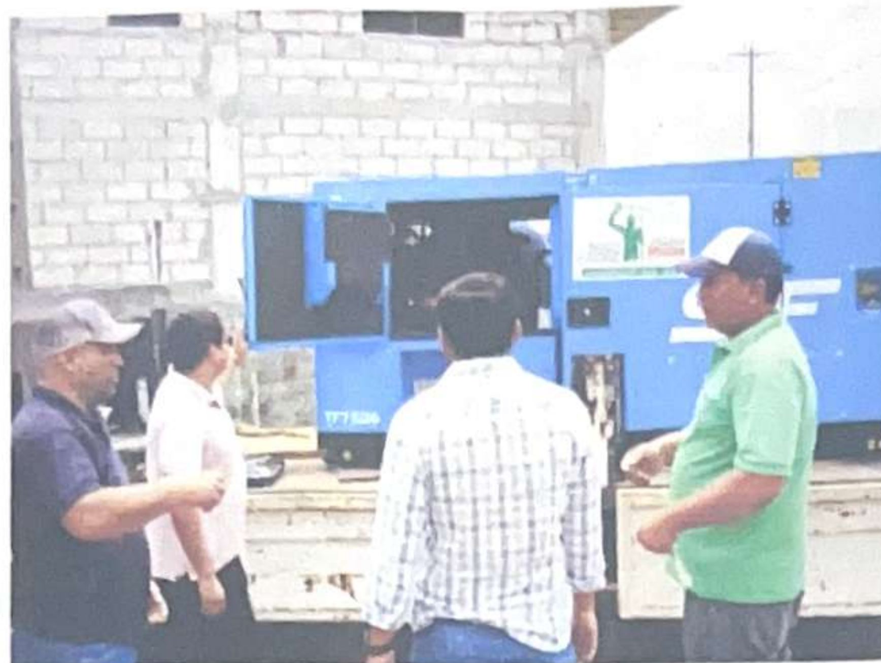
Fotografía 10: Visita a la estación de bombeo #2, donde realizó la entrega del nuevo
